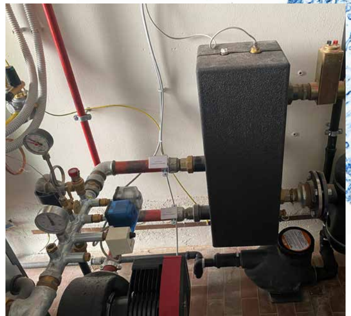
Válvula de corte de combustible y otros componentes
