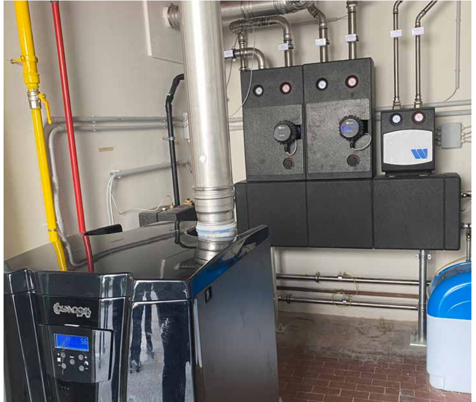
Central térmica y grupos hidráulicos y de mezcla
