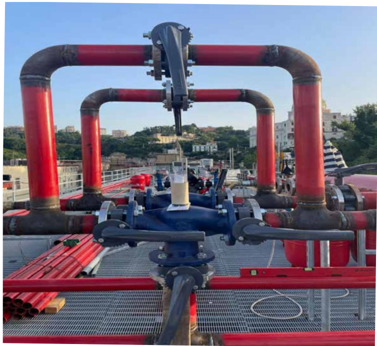
Una visión general de la instalación
