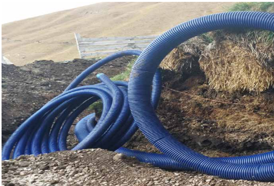
Una visión general de la instalación
