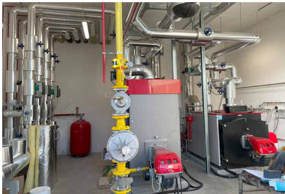
Una panoramica dell'impianto
