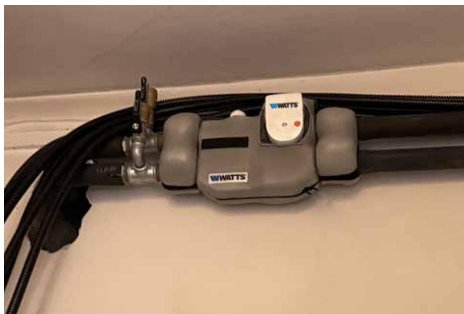
Una panoramica dell'impianto
